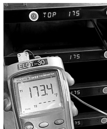
El pirómetro muestra una temperatura dentro de los 5°F (3°C) de la pantalla del gabinete, un margen aceptable.
