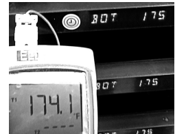
El pirómetro muestra una temperatura dentro de los 5°F (3°C) de la pantalla del gabinete, un margen aceptable.
